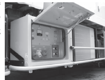
外部電源端子盤
