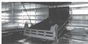
長さ10m×幅2.5m×深さ2.5mの 大型電着塗装設備
