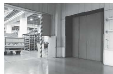
4トラックが丸ごと入る大型エレベーター
