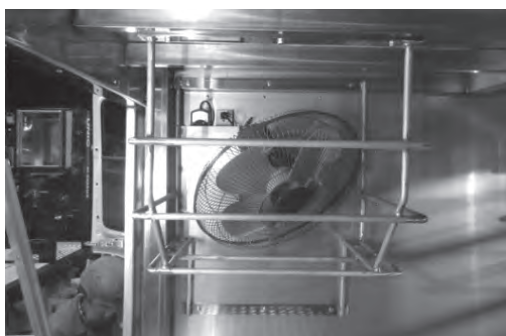
夏季の輸送は温度が上がるため、 サーキュレーターにより室内を換気
