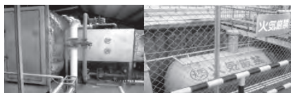
図1 熱風発生装置とLPGタンク
