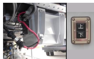
油圧ユニット・開閉スイッチの配線の断線
