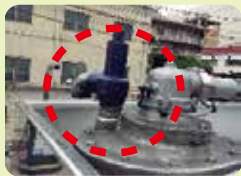
プレッシャーブレーカ不良
