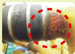
真空配管の錆び・腐食
