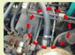
油圧ホース劣化・亀裂
