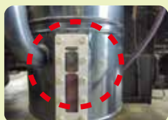
潤滑油の汚れ・劣化
