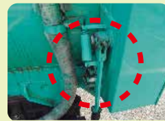
ハッチロック装置不良
