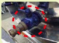
排出バルブ汚泥漏れ
