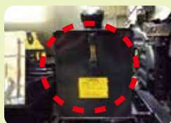
作動油の汚れ・劣化
