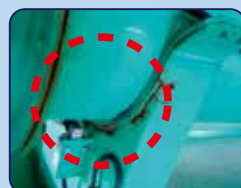
センサー固着及び錆び
