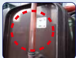
作動油の劣化・不足
