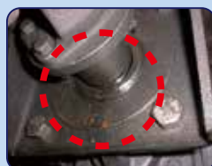
油圧ポンプ軸部油漏れ
