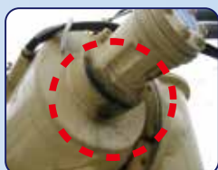
油圧モータ油漏れ
