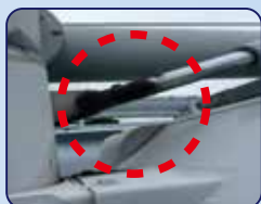
起伏シリンダ油漏れ
