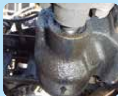
油圧ポンプ油漏れ
