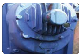
減速機の油漏れ
