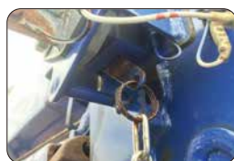
過巻スイッチ腐食
