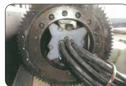
旋回台内ボルト折損
