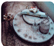
底弁シャフト・ハッチ錆
