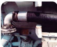
排出ホース劣化
